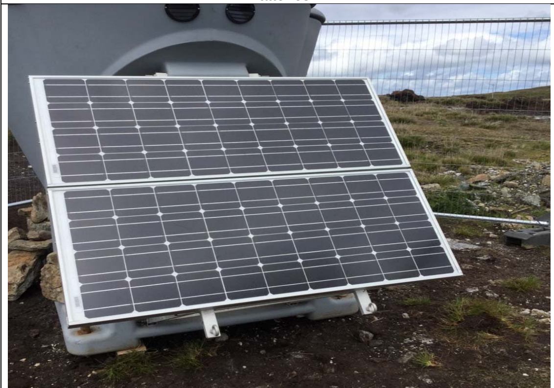
PV Module: Front
